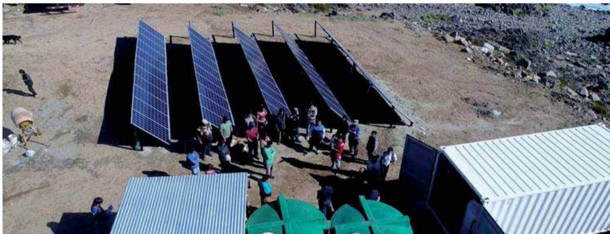
En la Región de Coquimbo, ya operan cuatro desalinizadoras a nivel local. Las que se encuentran en las caletas de Talcaruca, Maitencillo, Totoraillo Norte y Chigualoco. Esta última opera con energía solar (paneles fotovoltaicos).
